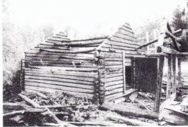
Under nedtagning. Skuten er avkledd og åsene fjernet. Undertaketets krumbøyde åser ligger fortsatt på plass. De fleste stokkene i denne langveggen var så råtne at de måtte kaseres.
